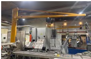
46. Pelarsvängkran Demag 500 kg
